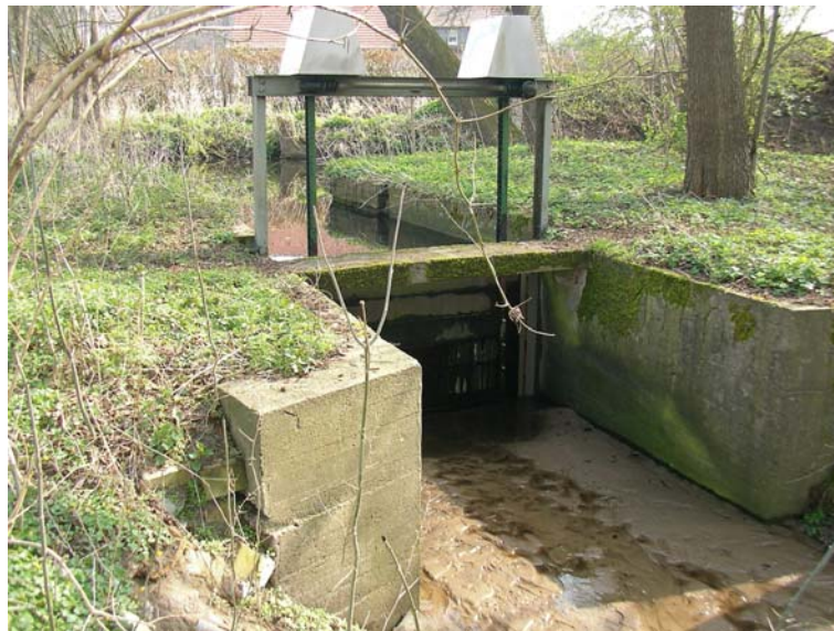
3.1. Erheblich veränderter Gewässerzustand: Reiherbach – Gewässerverbau, keine Durchgängigkeit
