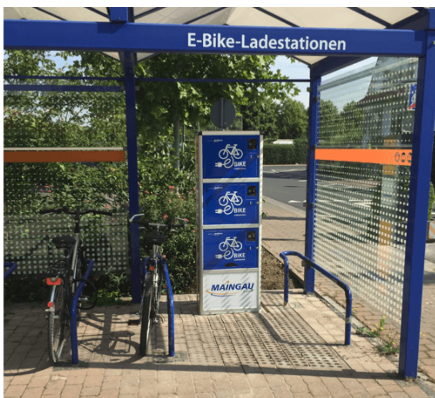
Bild 32: Beispiel für Fahrradabstellanlage und E-Bike-Ladestation mit Schließfachlösung (Quelle: BAUER)
