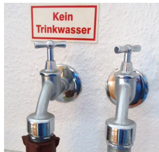
Beispiele für eine Regenwassernutzung: (v. o. n. u.: Zuleitung zu einer Regenwassertonne, Regenwassertonne, Kennzeichnung Entnahmestelle)
